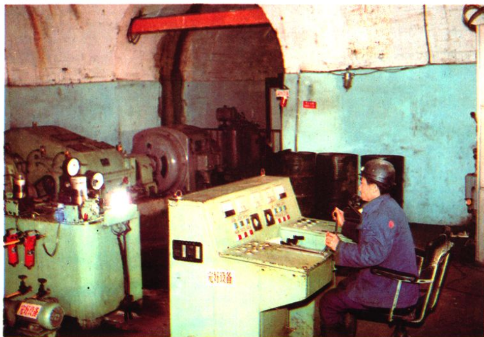
坛子口煤矿机电峒室
