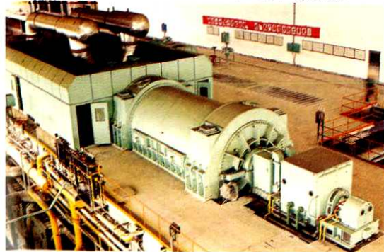
▽ 柳州火电厂 20 万千瓦发电机组
