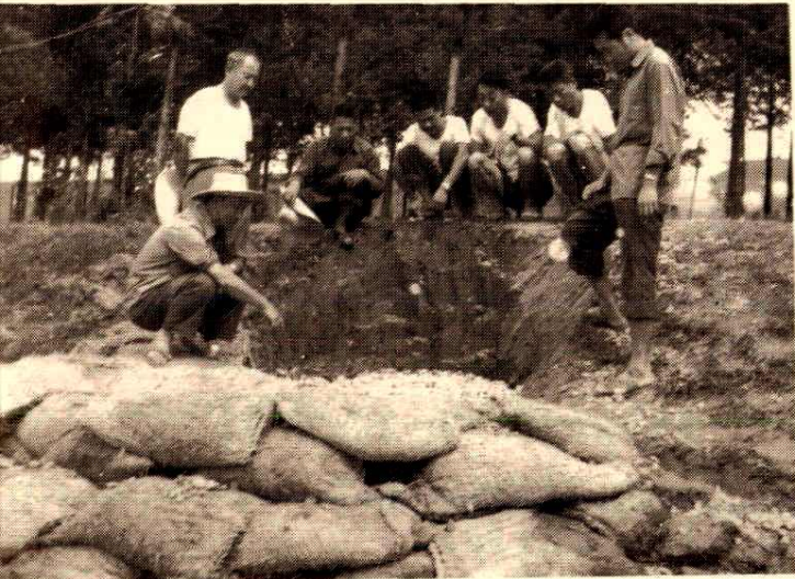
◁1983年罗家洲(287+630)管涌 险情 漆昌银摄
