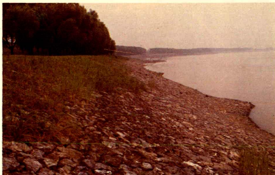
▷居字号崩岸险段
