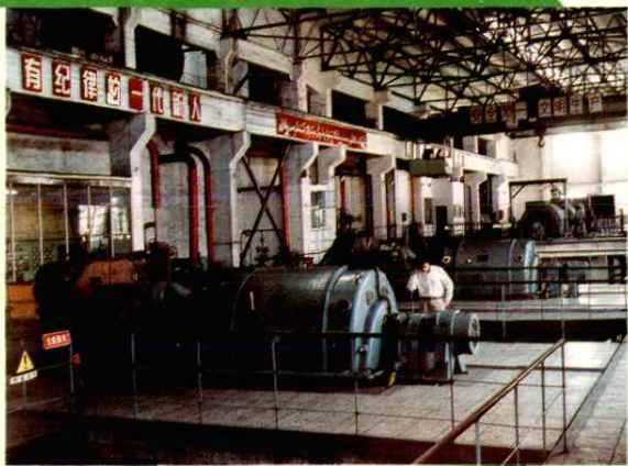
伊犁哈萨克自治州伊犁电厂(装机1.8万千瓦)
