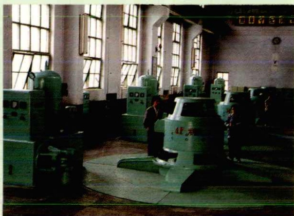
装机容量最大的水力发电站——石河子红山嘴水电站(装机5.705万千瓦)三级站
