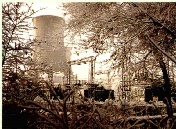
茅湖梁电厂升压站
