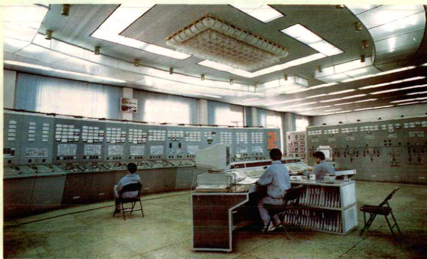
玛纳斯电厂主控室
