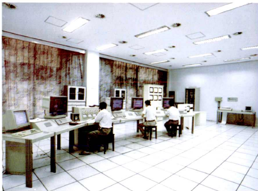
浙江绿纶厂中央控制室
