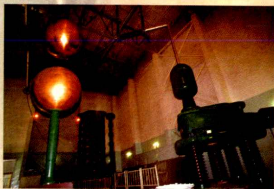
50 万伏工频试验变压器
