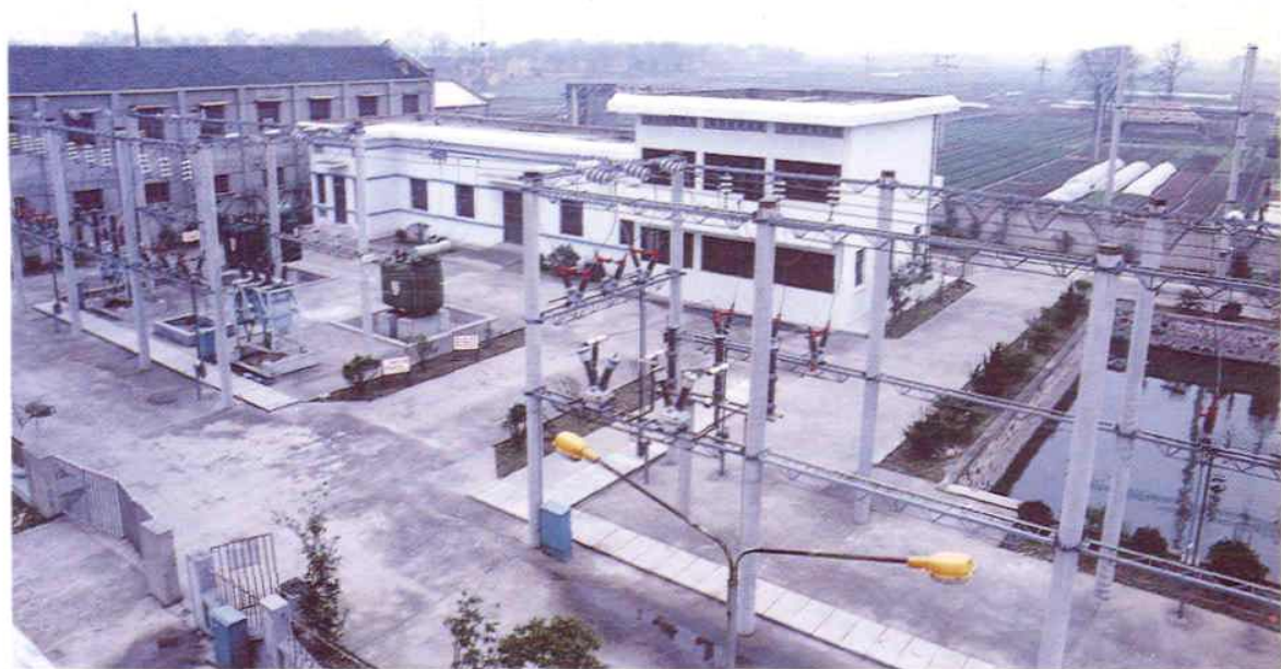
35 千伏省农电标准化变电所——丹阳变电所
