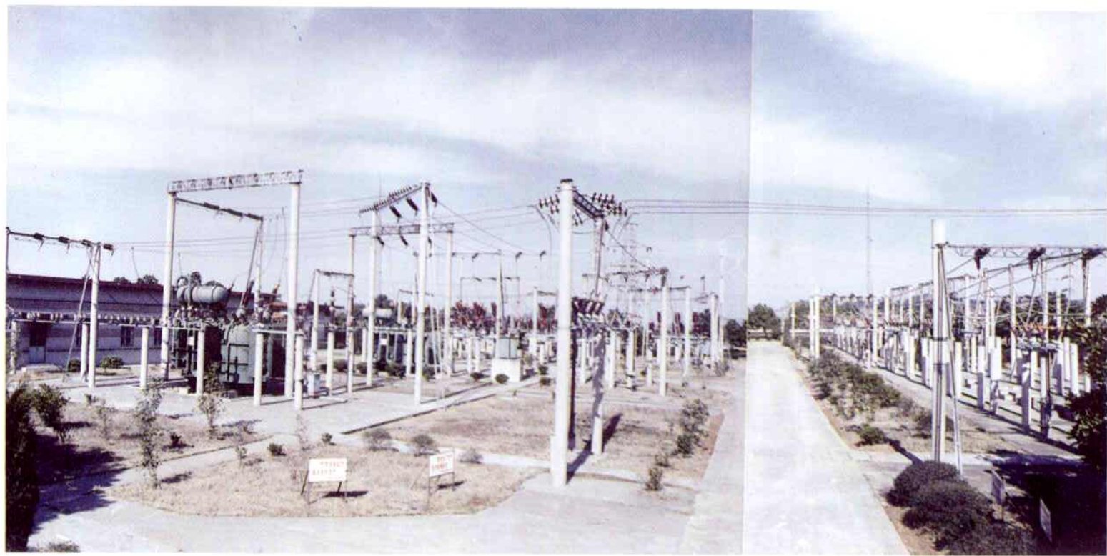
110 千伏当涂变电所全貌
