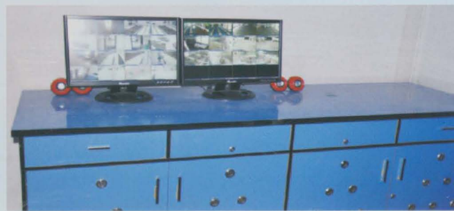
■ 校园监控系统控制室
