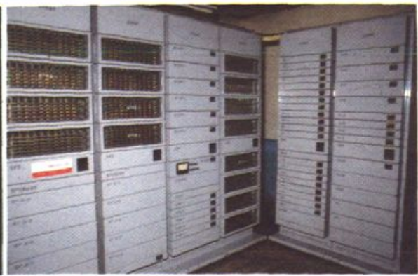
通讯交换机室
