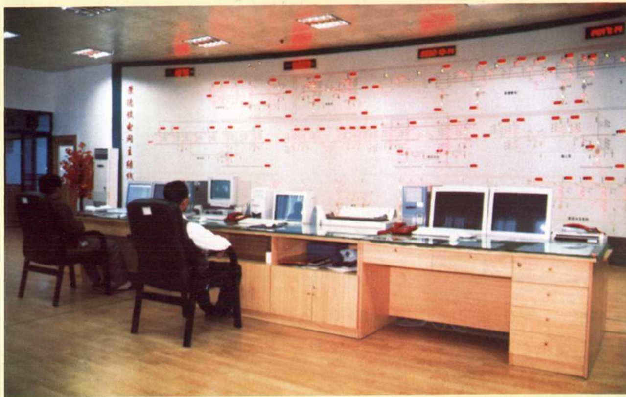
地区调度控制室
