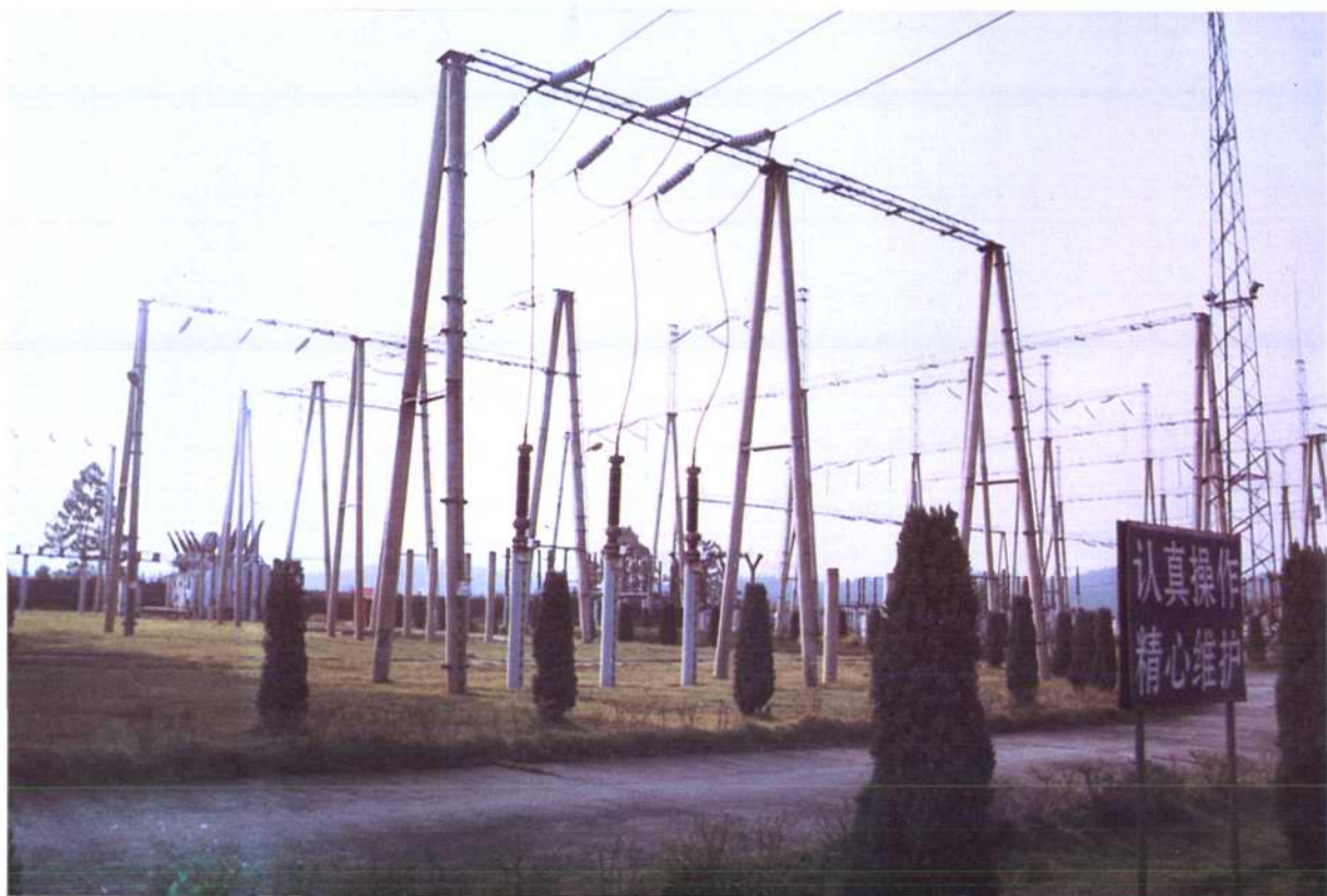
220千伏蛇龙变电站
