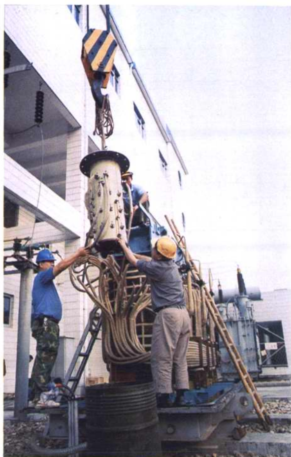
110千伏主变吊芯试验
