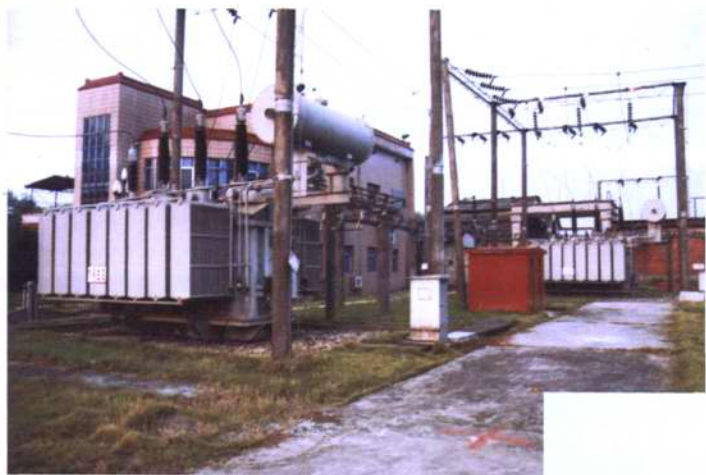
110千伏黄泥头变电站
