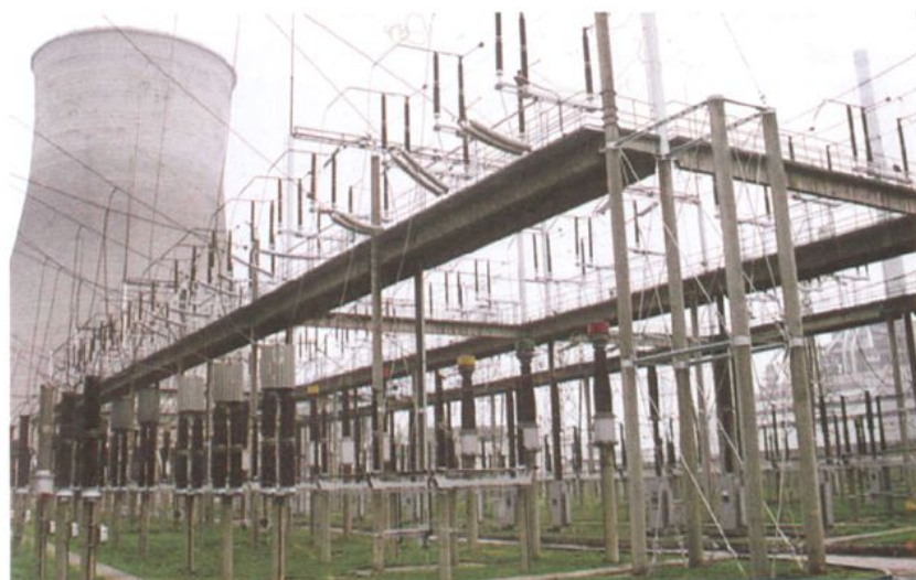
● 内江发电总厂输电网。
