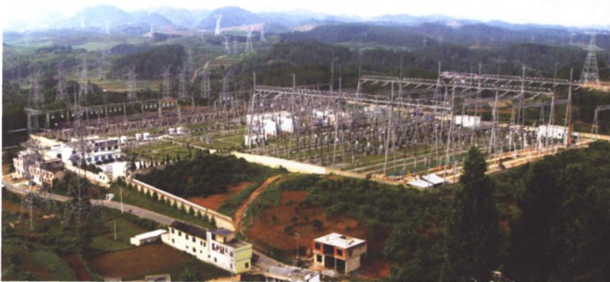
卓岭500千伏变电
