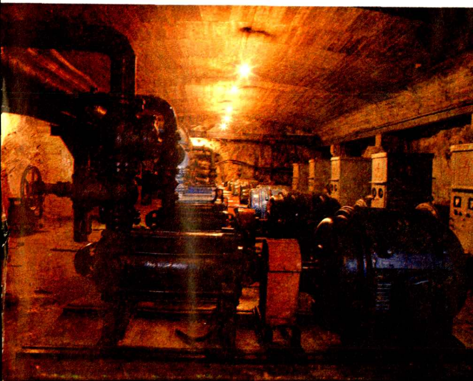
铅锌矿五中段水泵房
