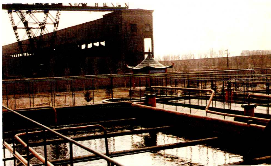
▷包头钢铁厂焦化厂污水处理设施
