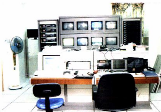
校园网总控室
