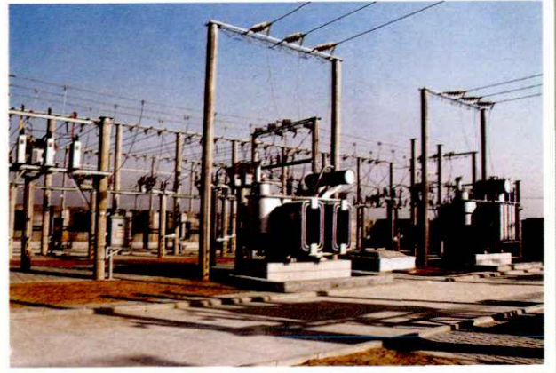
张庄 35 千伏变电站
