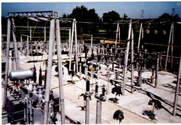
耿庄 110 千伏变电站
