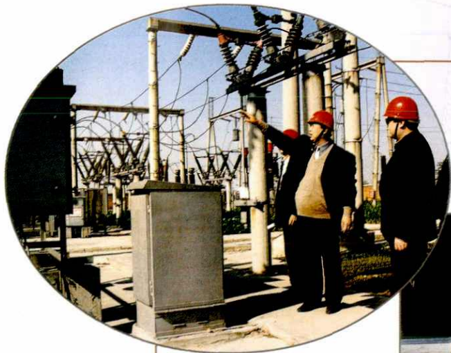
副局长刁法良（右二）到变电站检查工作
