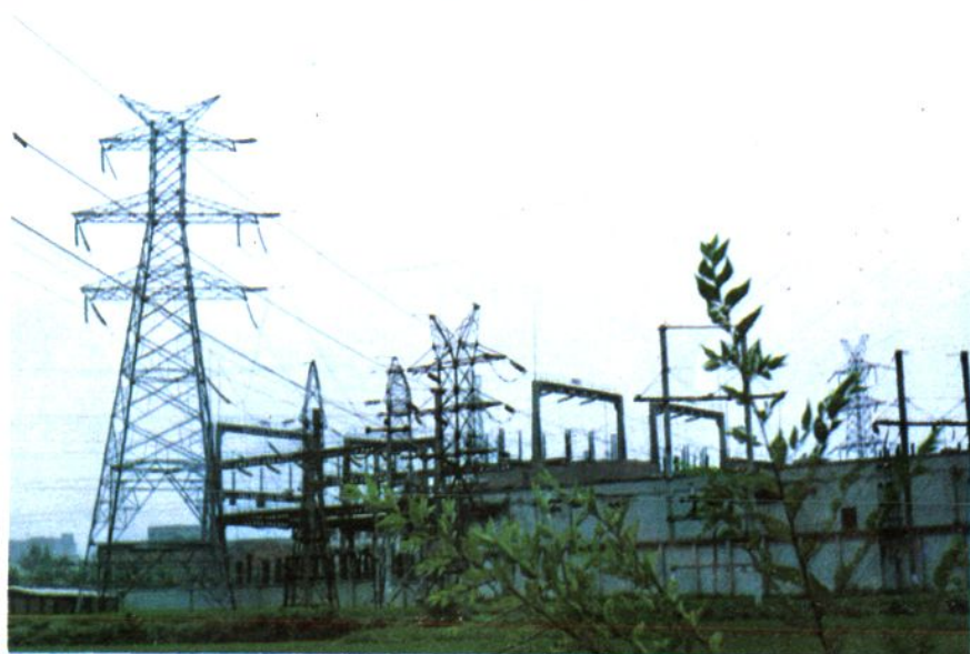
青白江 35 供电站
