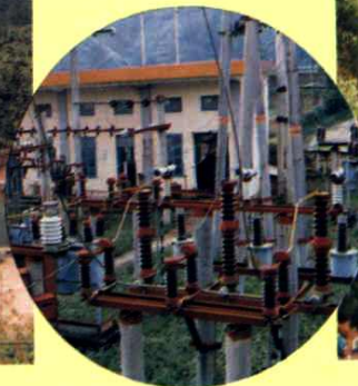
坑口镇变电场
