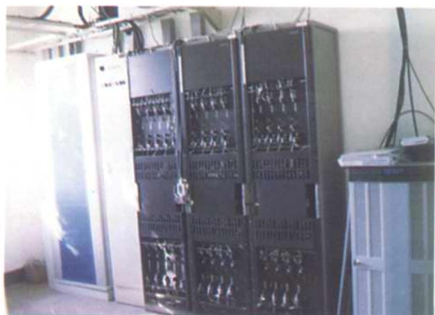
市邮电局移动通信设备
