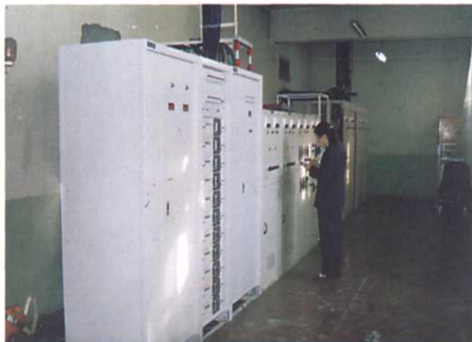
市邮电局电力室
