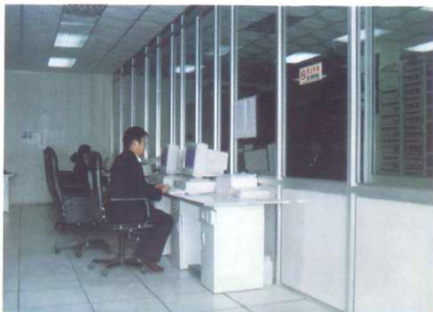
市邮电局程控机房终端控制室
