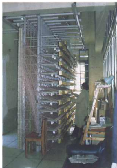
市邮电局测量室
