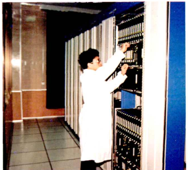
程控电话机房一角
