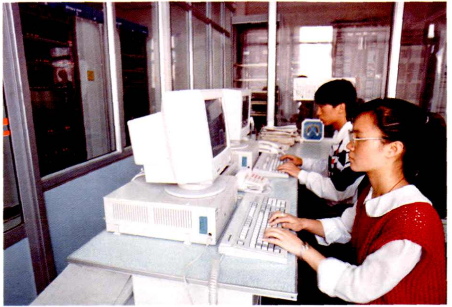
程控电话机房
