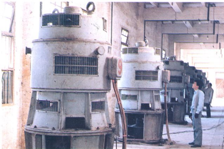
马安围大湖溪排涝站机组
