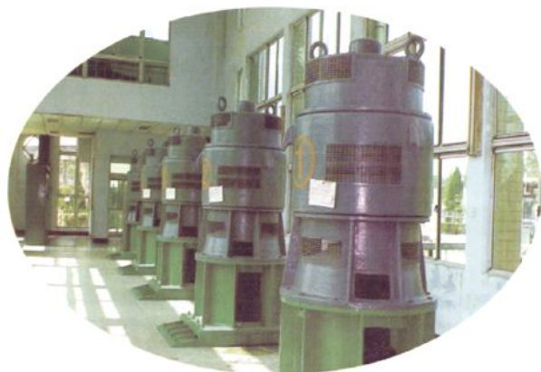
范楼站增容后的配套机组(2006年9月摄)
