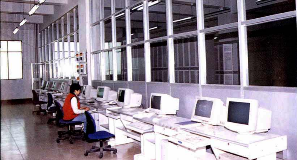
数字移动电话机房
