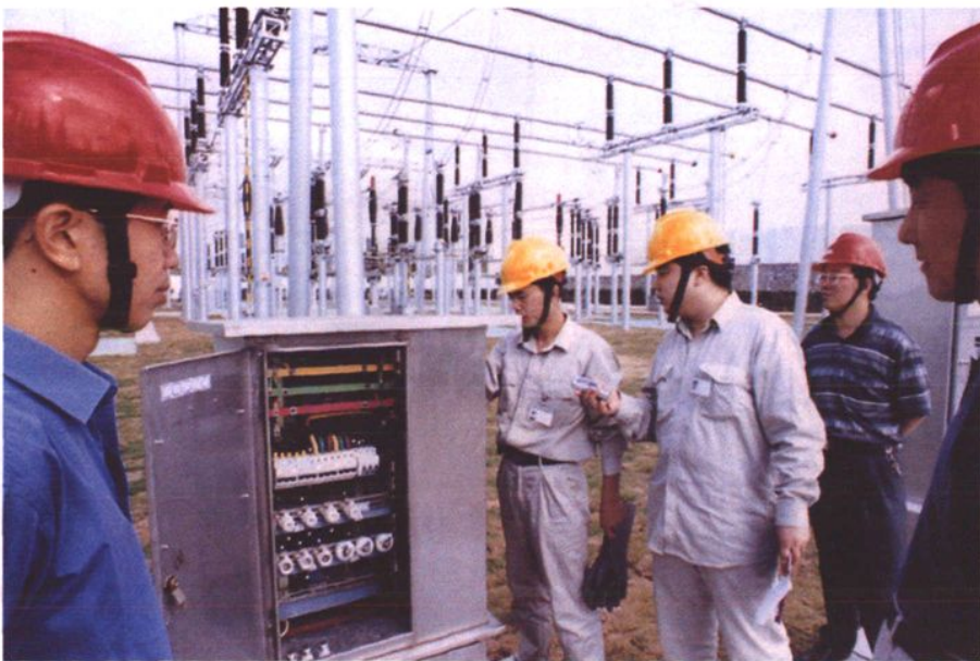
220千伏 上党开关站 启动(2000年 9月摄)
