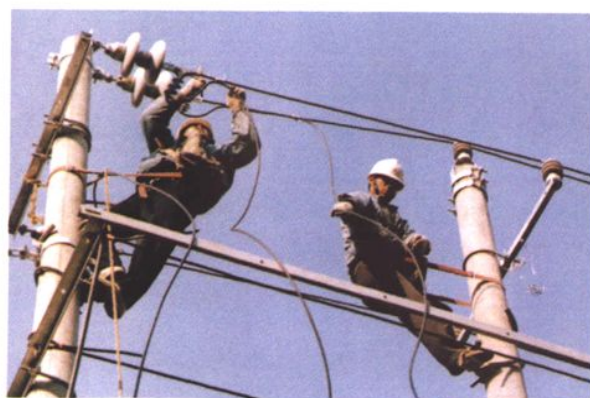
镇江城市电网改造 (1999 年 6 月摄)
