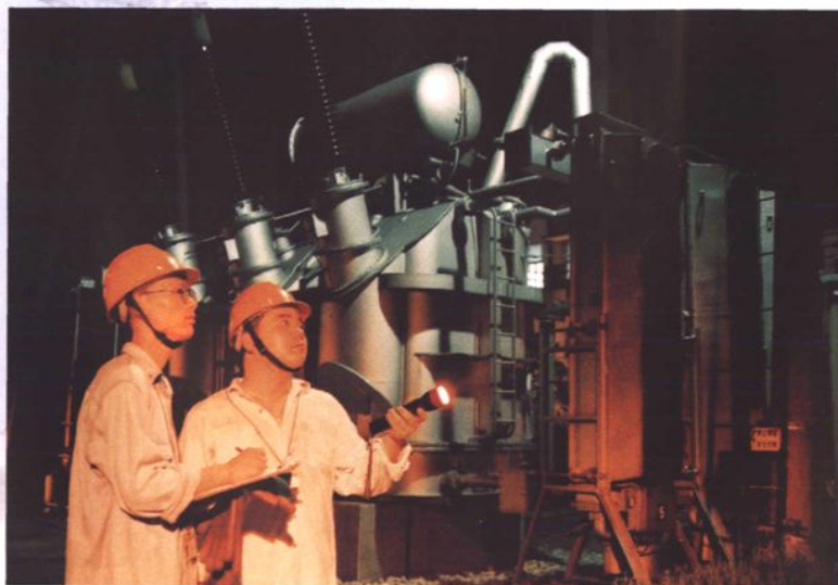
镇江供电局进行变电所夜巡(1999年10月摄)
