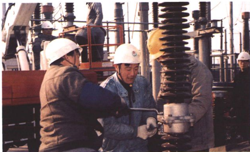
220 千伏官塘变 电所更新改造(2000年 11月摄)
