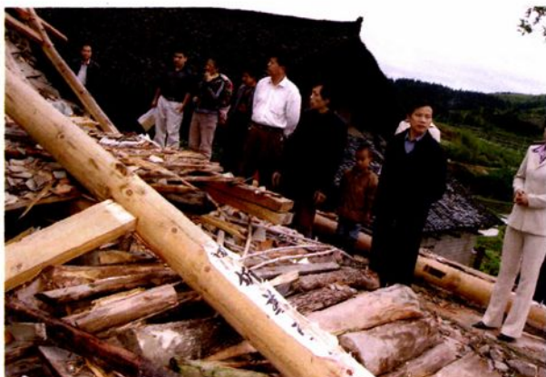
副县长何龙清到高屯察看被风暴吹倒的房屋场景。
