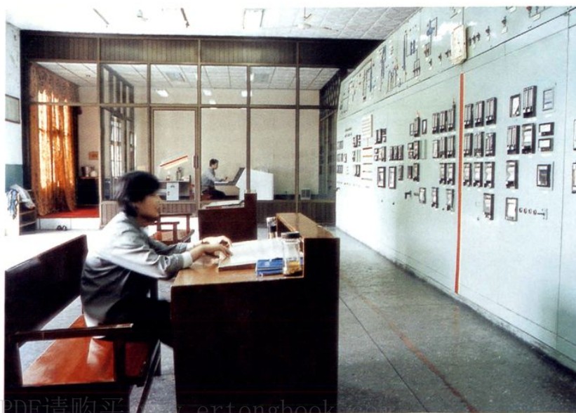
氯碱厂烧碱控制室
