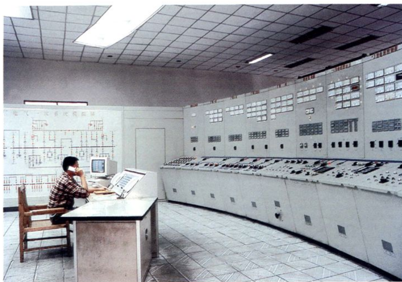
热电厂控制室
