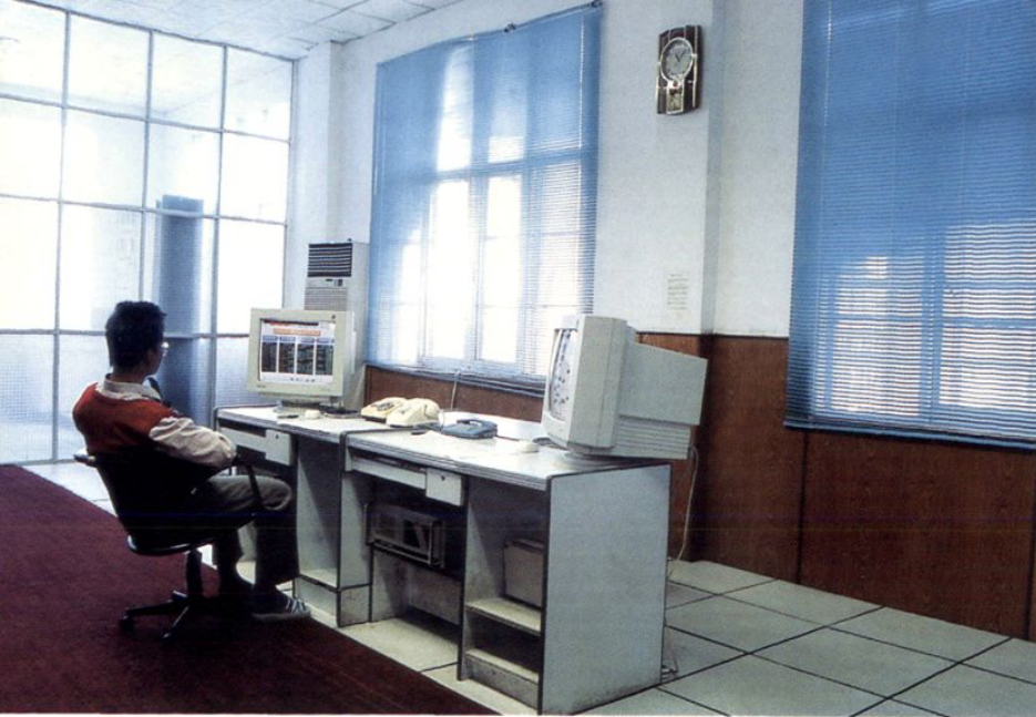
氨厂油气化车间控制室
