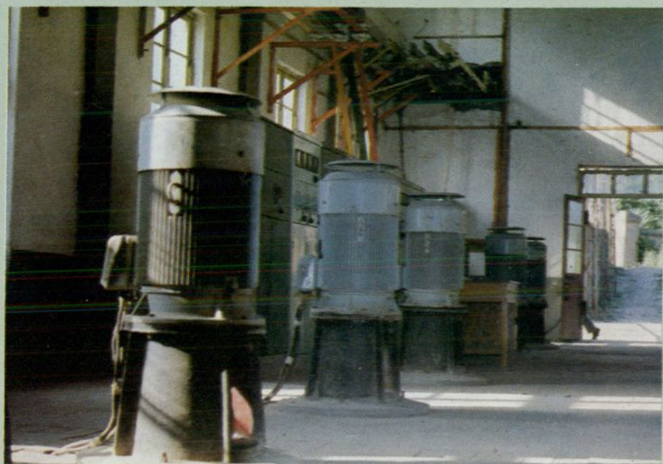
子牙扬水站内景
