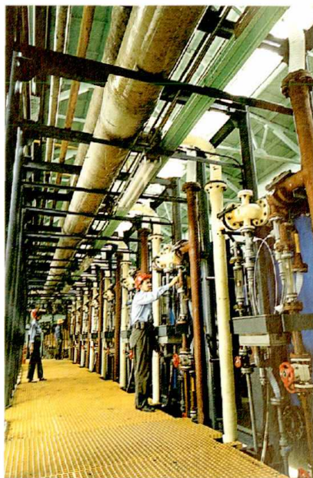
天原集团烧碱车间
