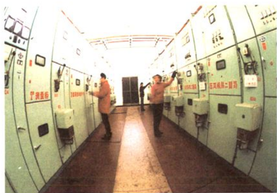
地面中央变电所
