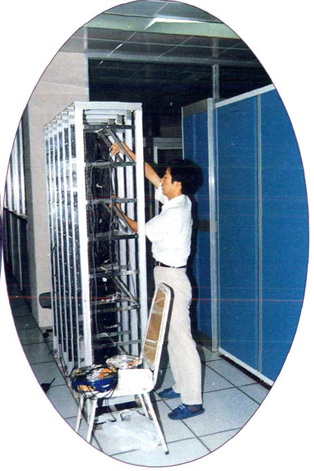
移动电话机房。
