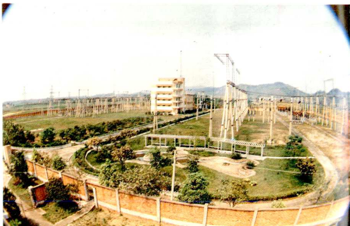
林村220千伏枢纽变电站 总容量9万千伏安
