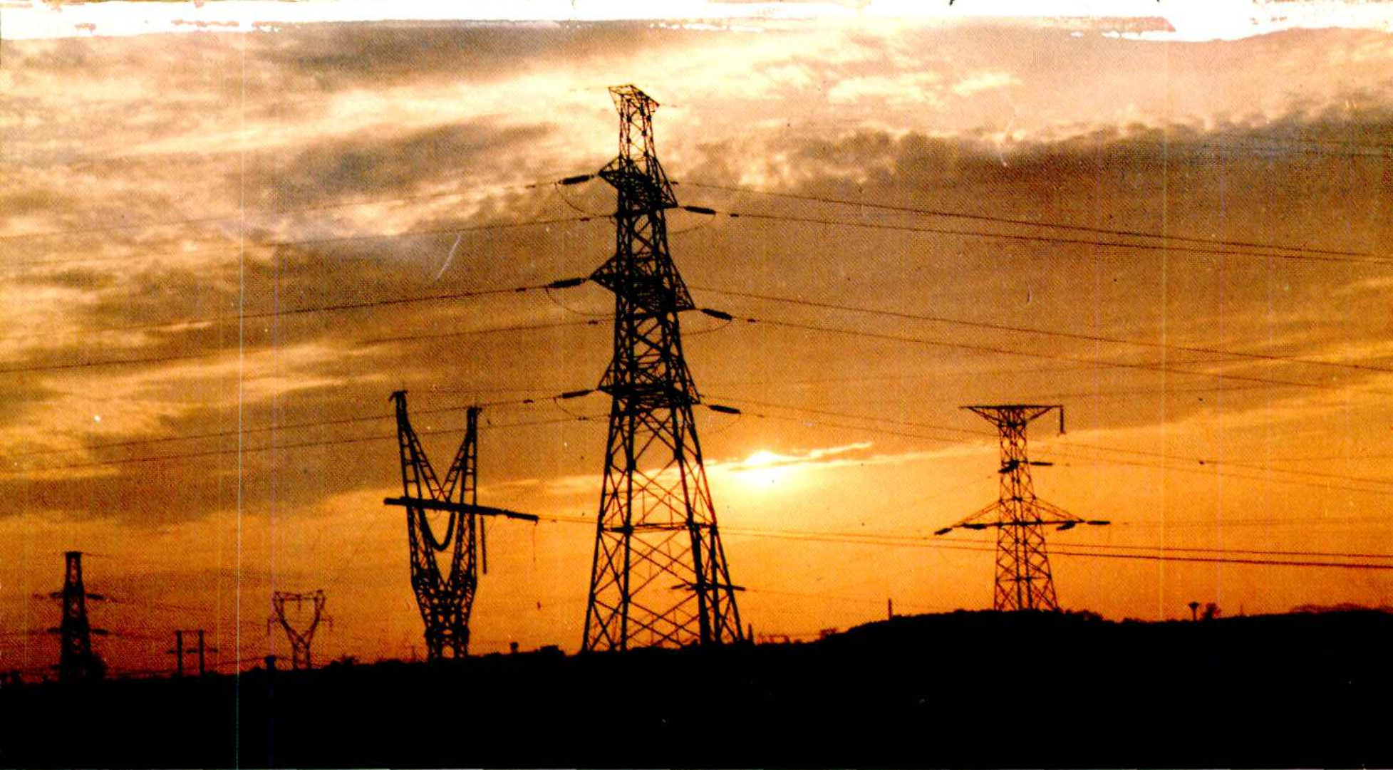
220千伏线路铁塔群
