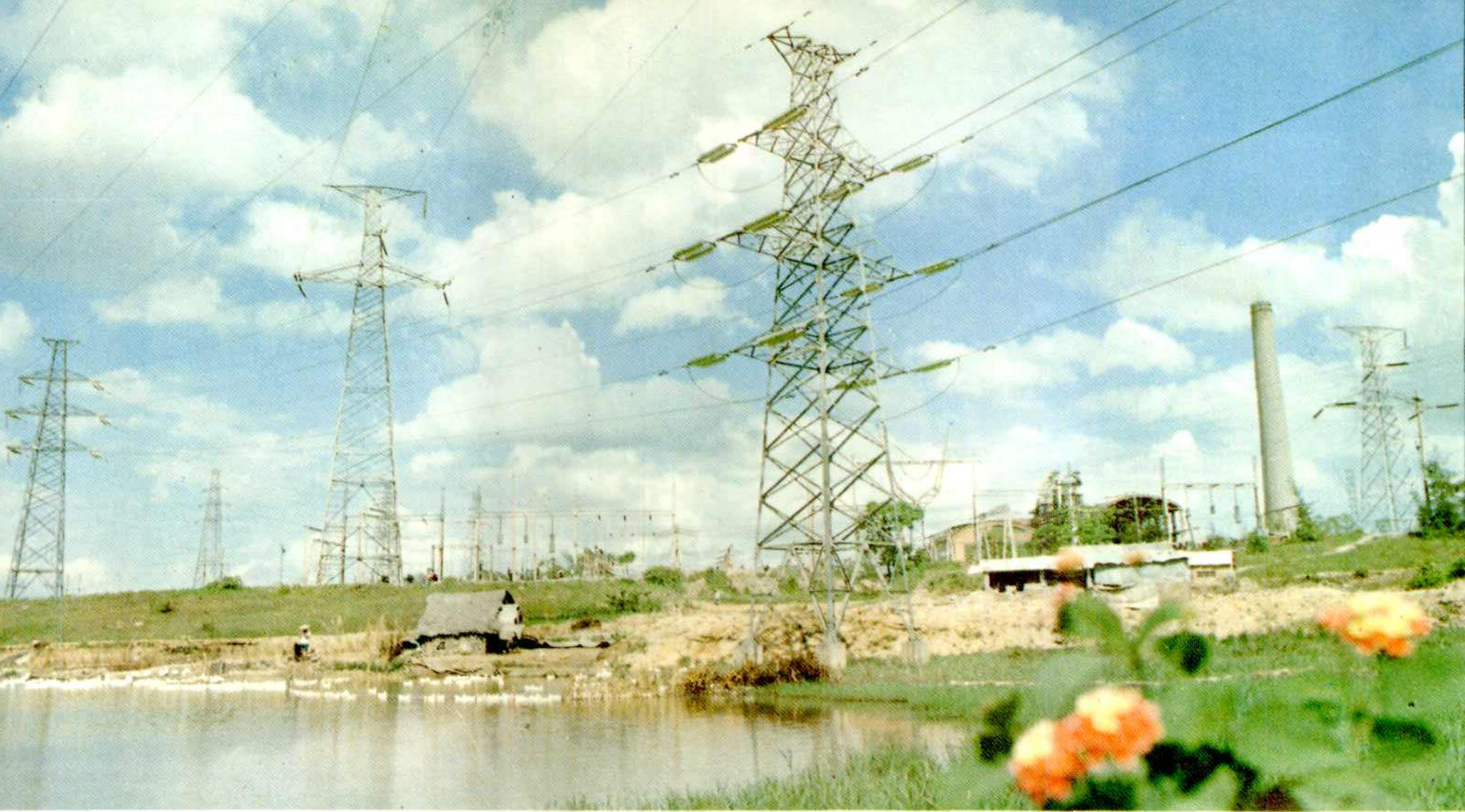
西津—南宁、大化—南宁220千伏输电线路
