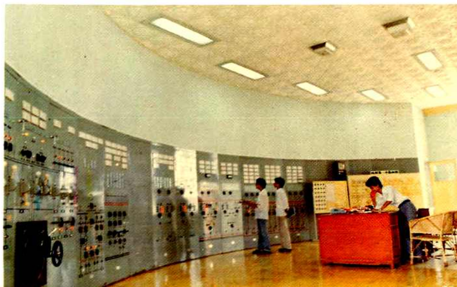
林村220千伏枢纽变电站控制室
