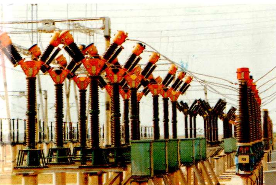
220千伏变 电站油开关一瞥
