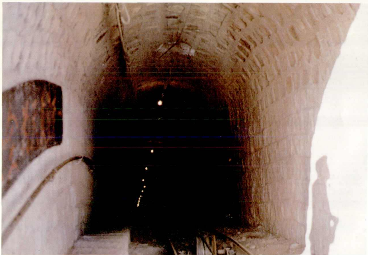
塔城地区建矿指挥部施工的铁厂沟煤矿4号井主斜井井筒
