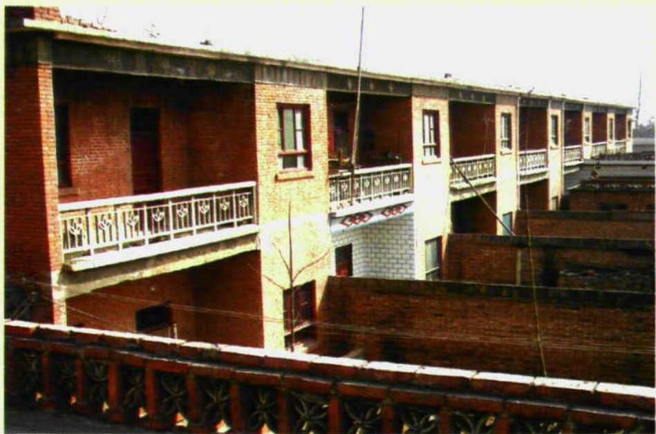
兴建于上世纪80年代初的居民楼。当时共建6栋。 图为北二街西头的一栋。
