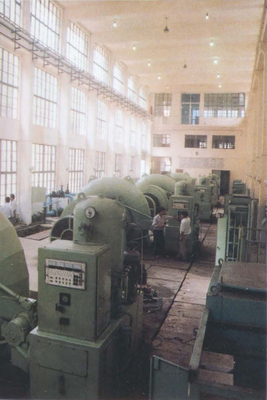
田阳县福禄河 四级电站发电 机房
