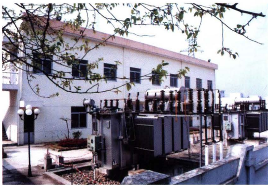
2001 年重建的 35 千伏方山变电所
