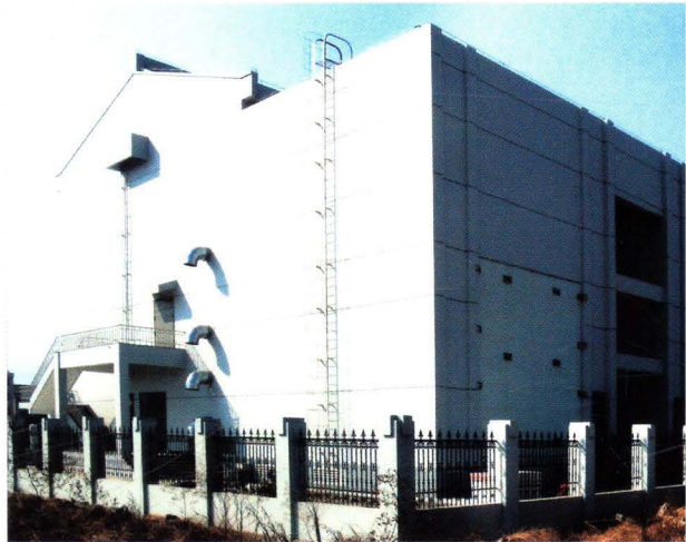
110 千伏雅林变电所 (户内式)
