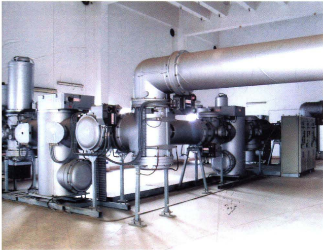
SF6 全封闭组合电器 (GIS)
