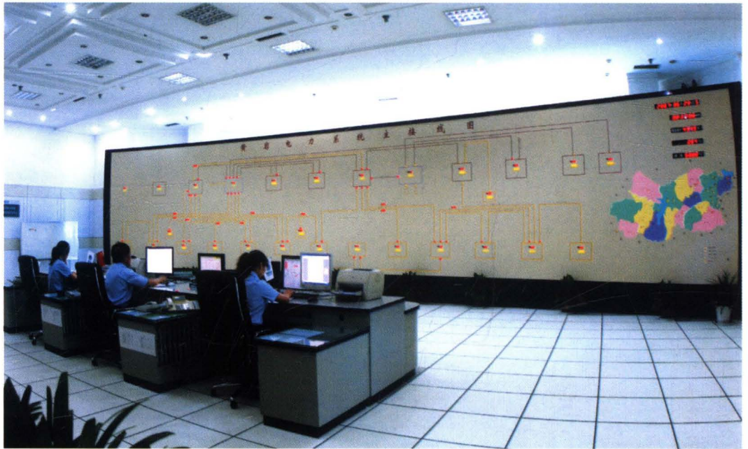
黄岩电力调度中心
