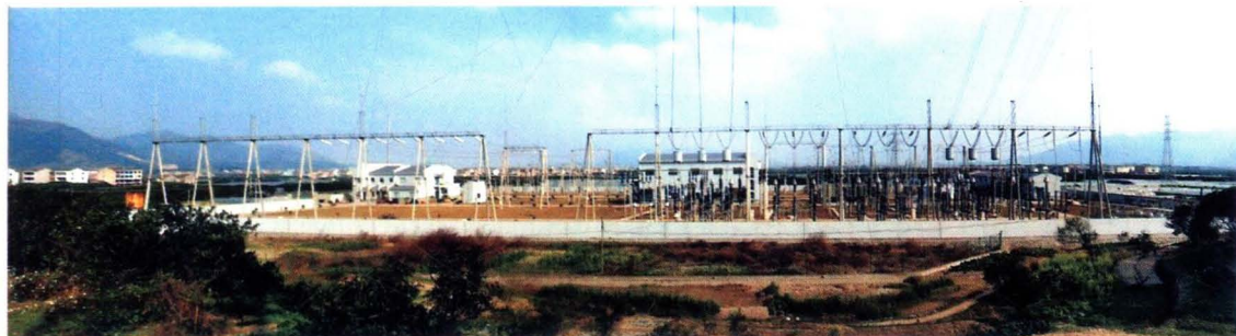
220 千伏剑山变电所
