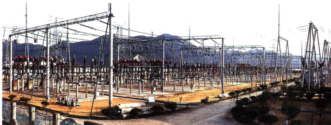
220 千伏桔乡变电所
