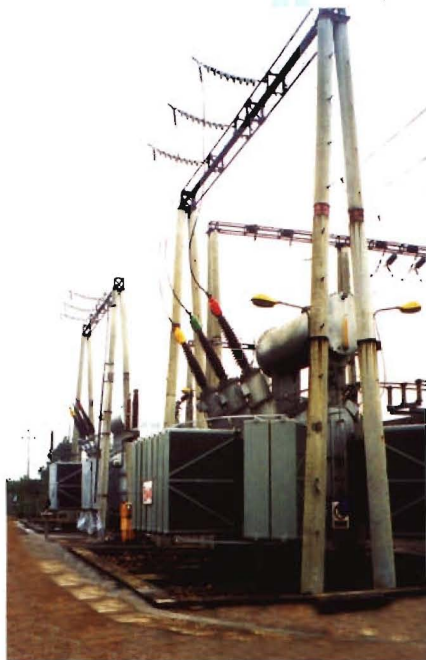
110 千伏北郊变电所主变压器
