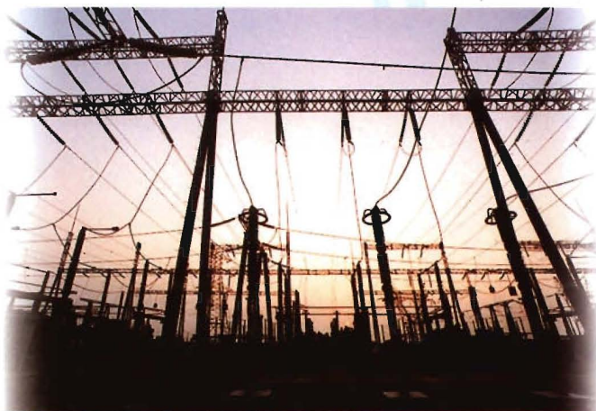
220 千伏金华变电所一隅
