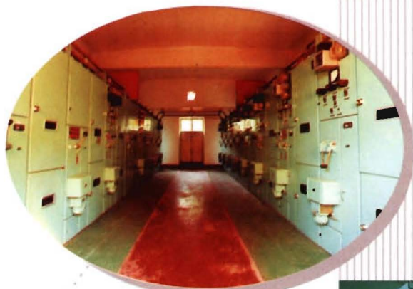
汤溪变电所开关室
