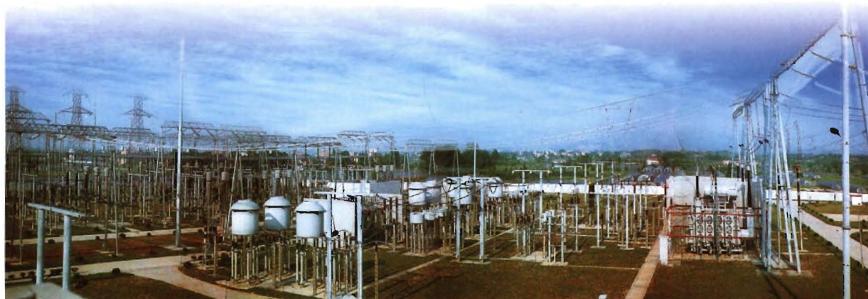
500 千伏双龙变电所户外设备
