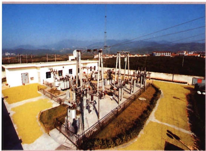
赤松变电所俯视
