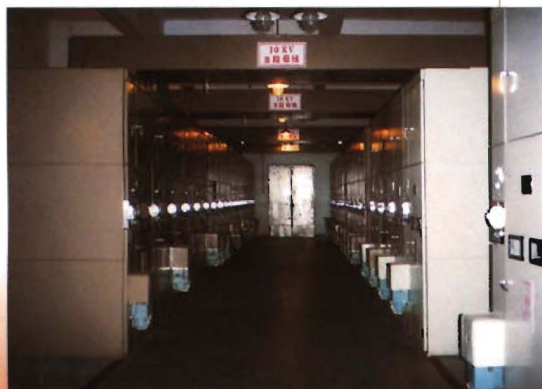
110千伏站前变电所 10千伏开关室
