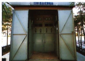
市区组合式配电站
