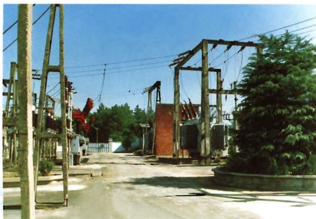
110 千伏湖海塘变电所
