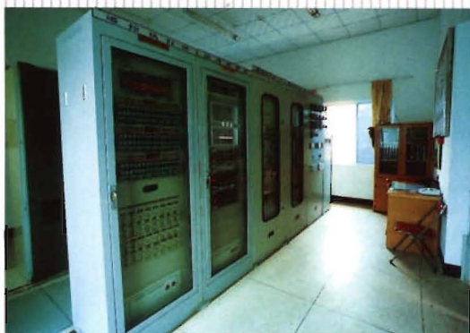
罗埠变电所控制室
