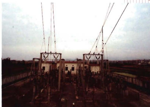
澧浦变电所全景
