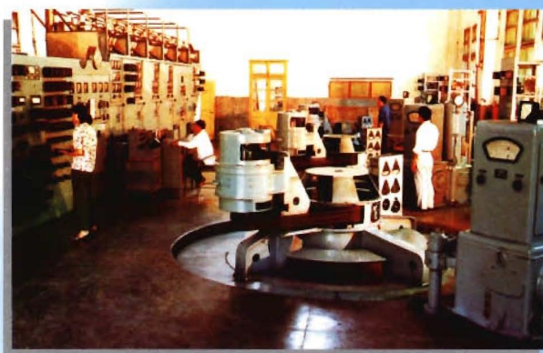
金兰一级水电站发电车间
