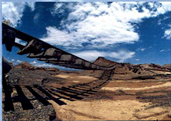
◀1998年7月13日,兰新线遭遇特大洪水侵袭,铁路十余处轨排悬空。
