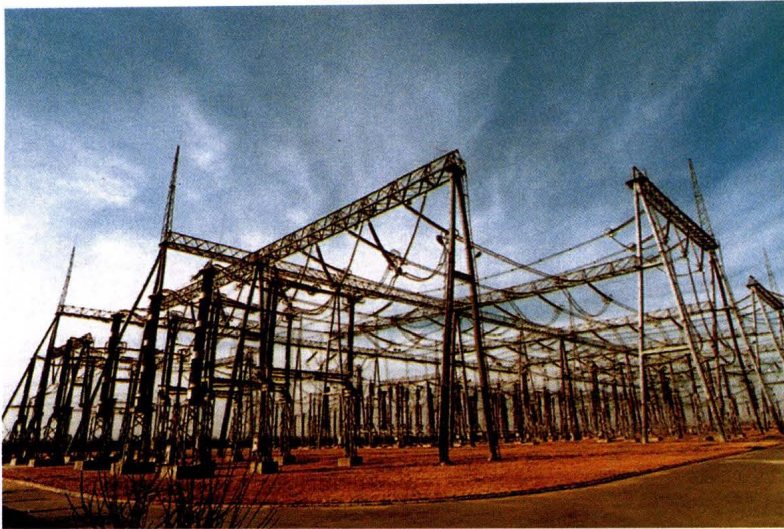
东北电网500千伏沙岭变 电站
