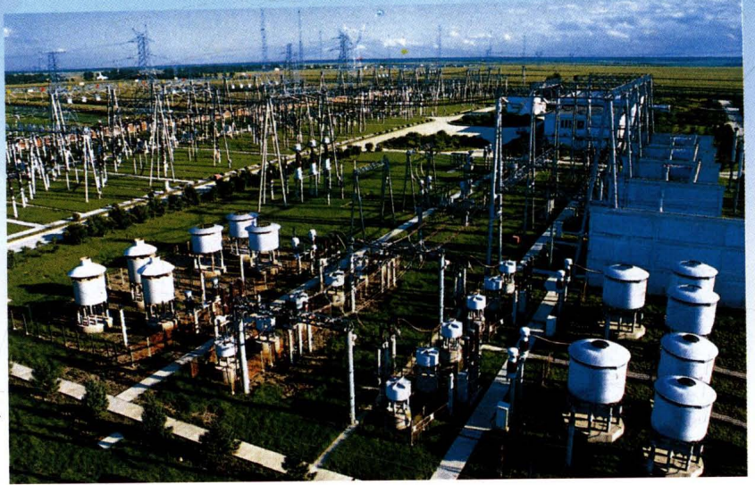
东北电网500千伏哈尔滨 滨哈南变电站
