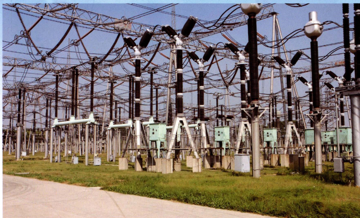
东北电网500千伏董家变电站
