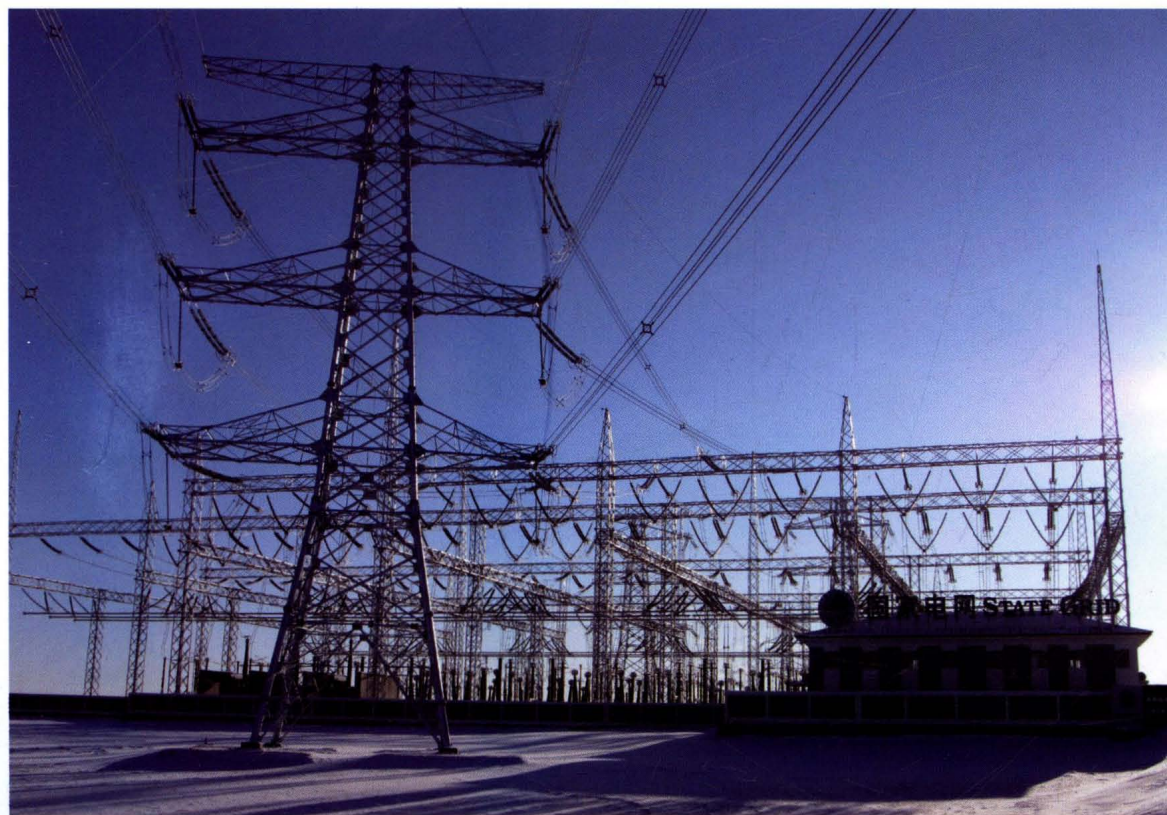
东北电网500千伏巴彦托海变电站
