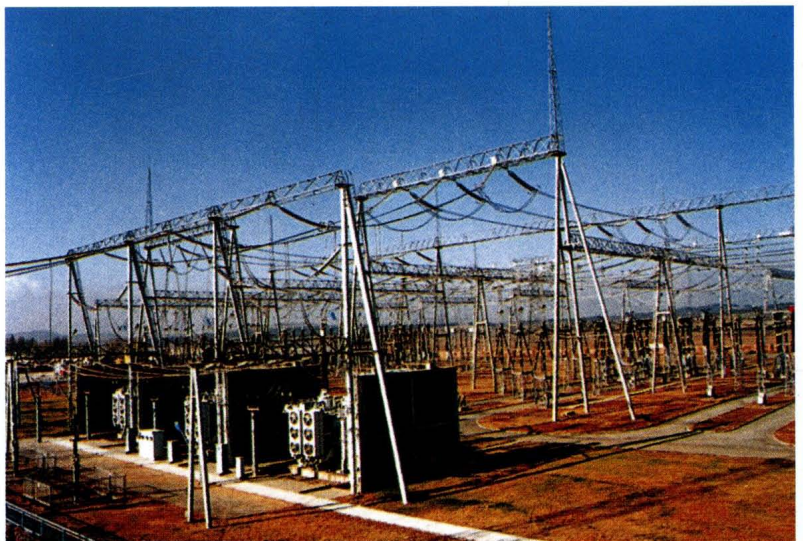
东北电网500千伏长春合 心变电站
