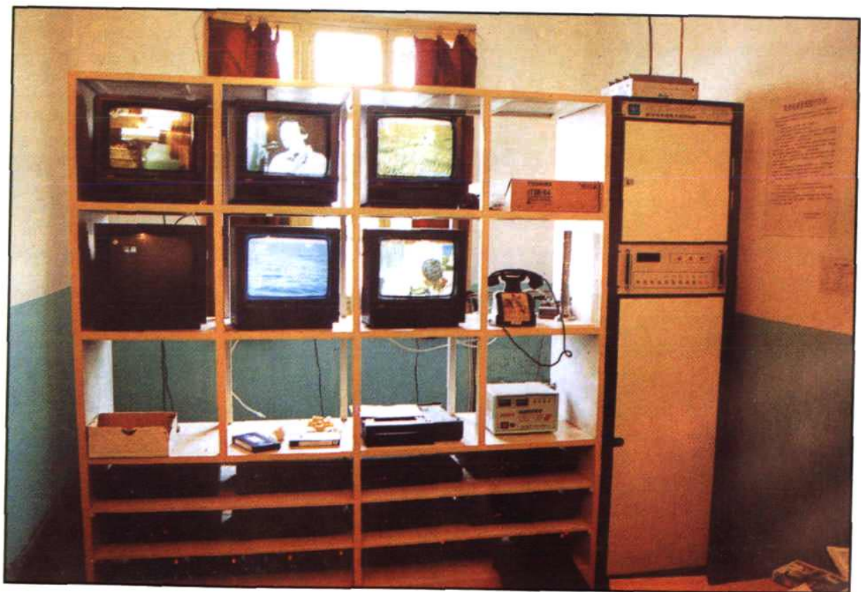
閉路電視機房
