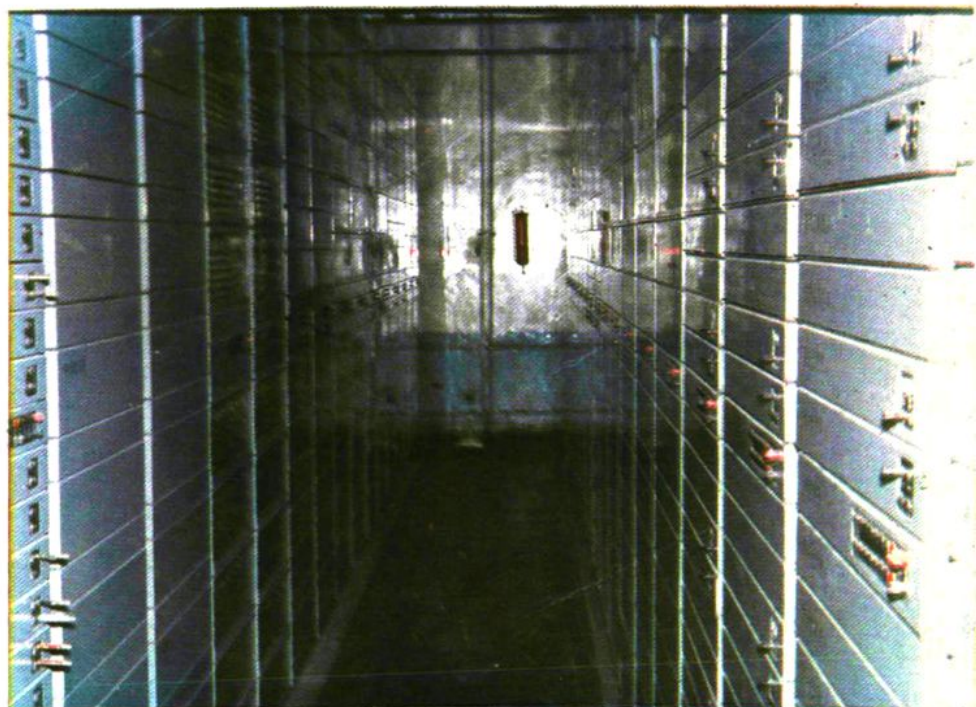
⇒ 纵横制交换机房
