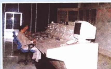
新源糖厂中心控制室
