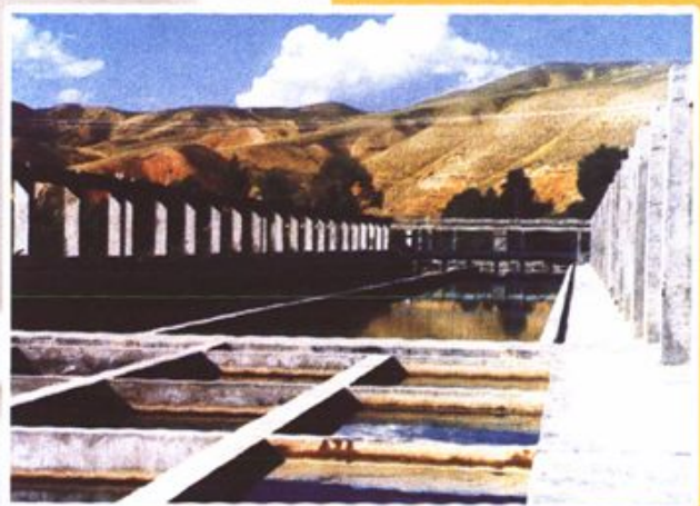
新源县自来水厂平流反应沉淀池
