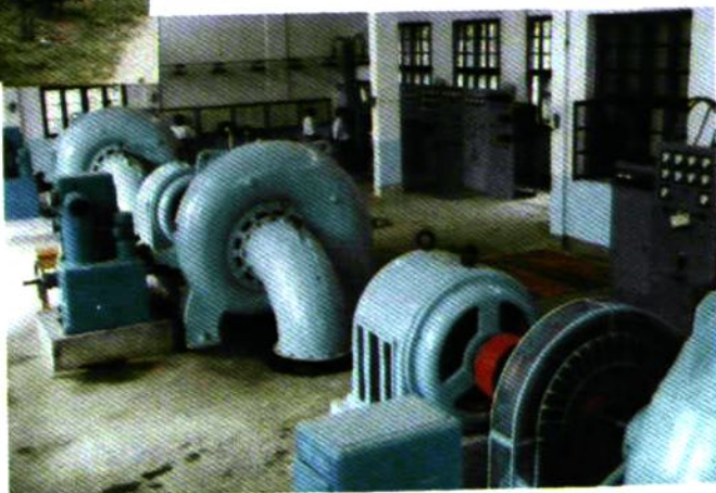
牯牛背一级水电站发电机房
