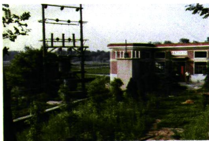
双港镇合永长圩电力排灌站
