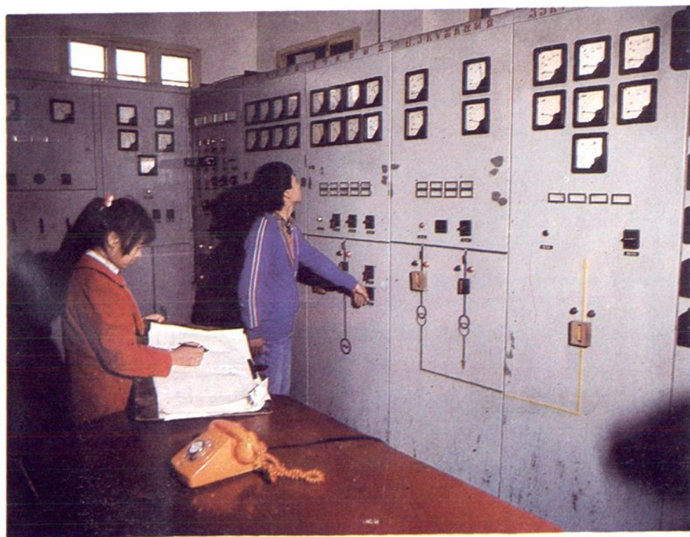
电站中央控制室
