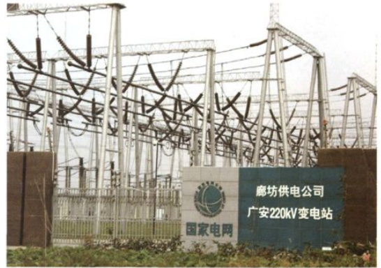
广安220KV变电站
