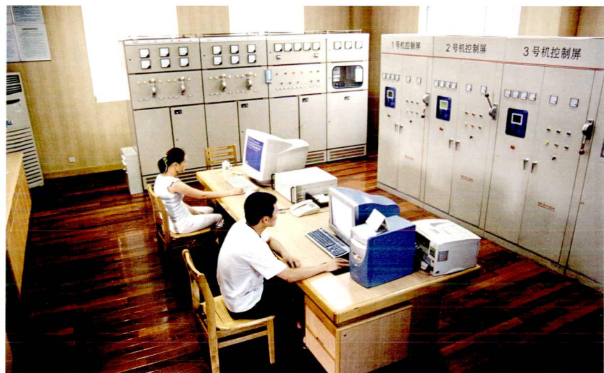
艇湖水电站中控室
