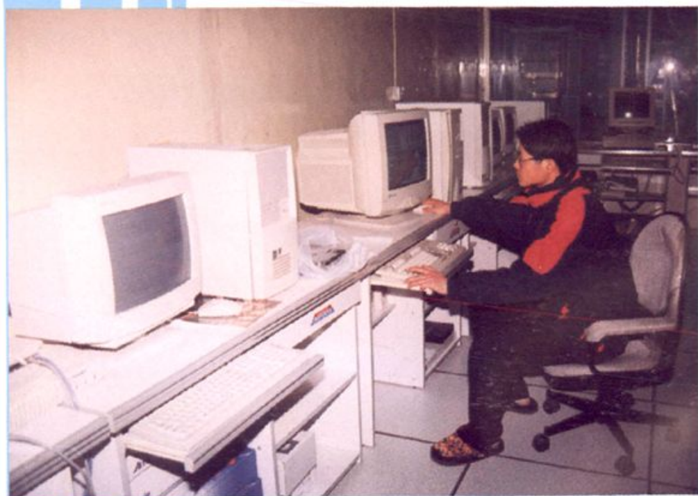
市邮电局传输监控机房一角
