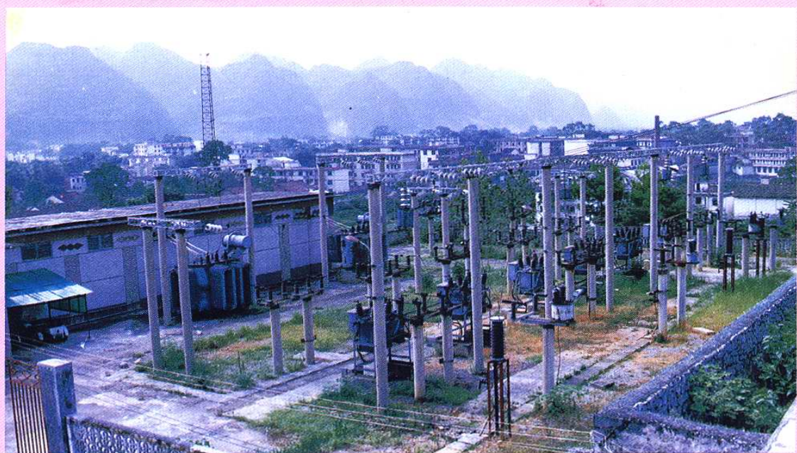
都安中心降压站
