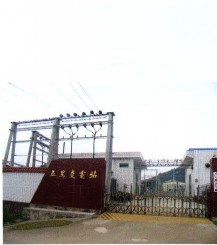
▲ 35千伏五里变电站
