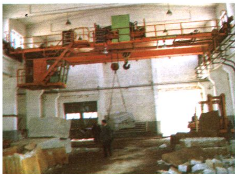
⑥ 20吨电动双梁吊车
