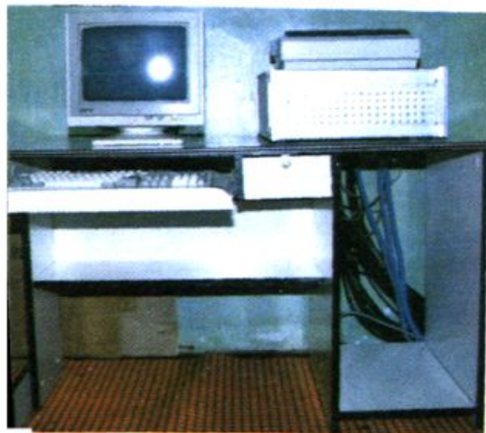
新扩建的微机操作室▼
